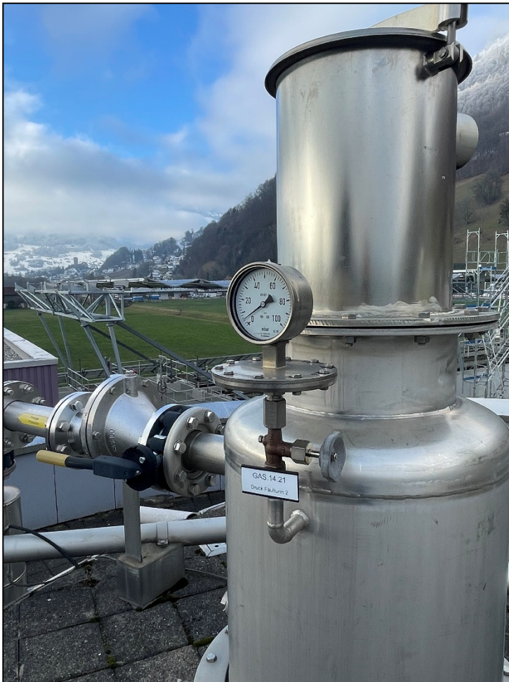
Gasentnahme beim Faulbehälter mit Druckanzeige
